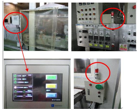
(監控與警示設備)
